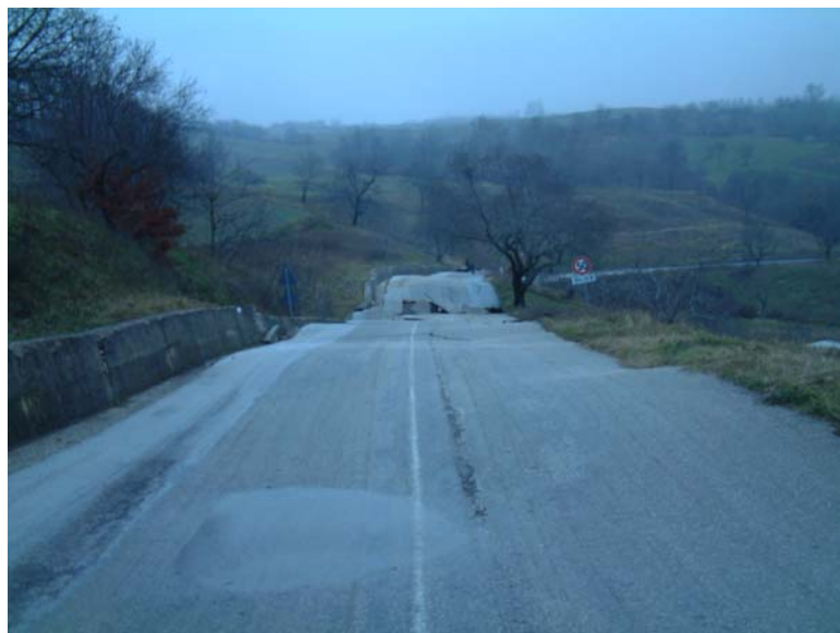
Fig. Frana di versante nel territorio del comune di Campolieto
